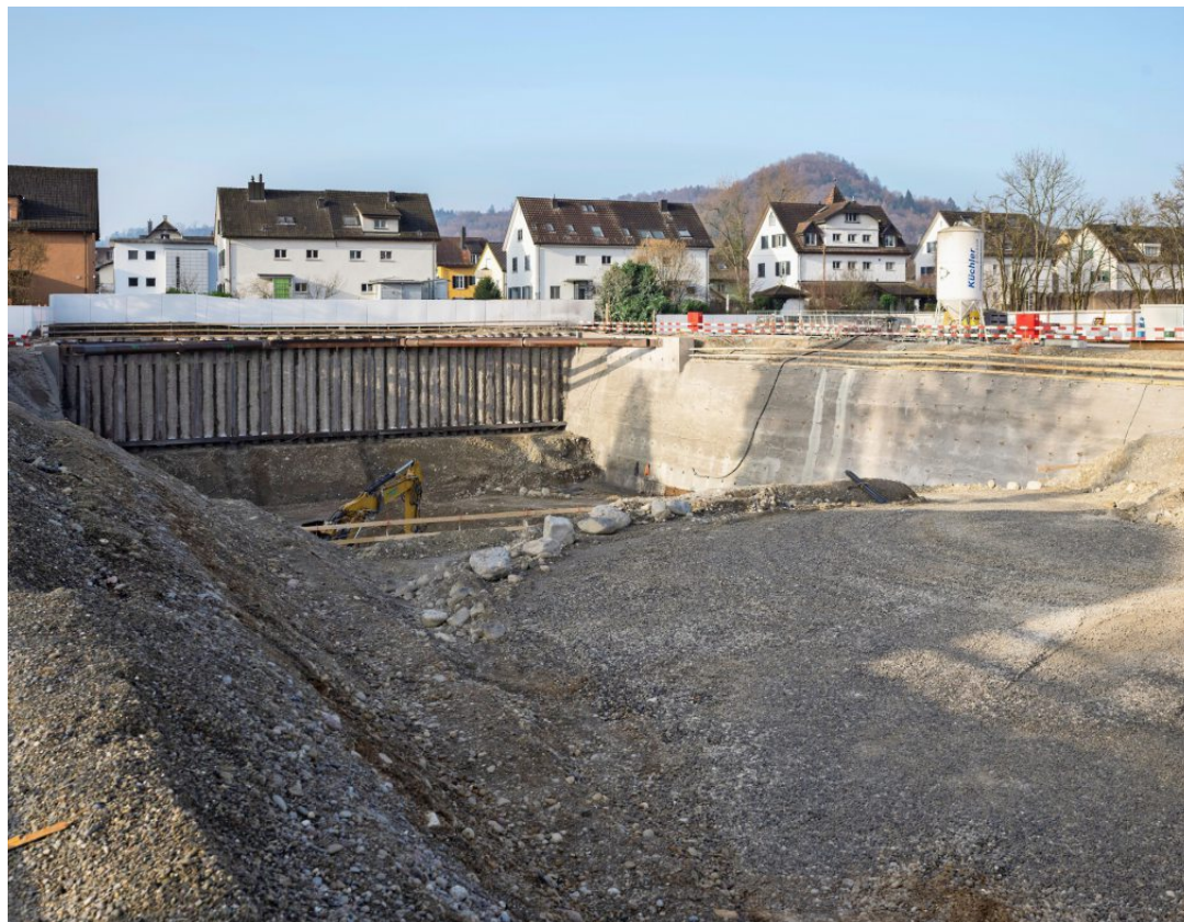
Statt Parkdeck und Sportwiese befindet sich bei der Kanti Baden eine riesige Baugrube für den Erweiterungsbau.
